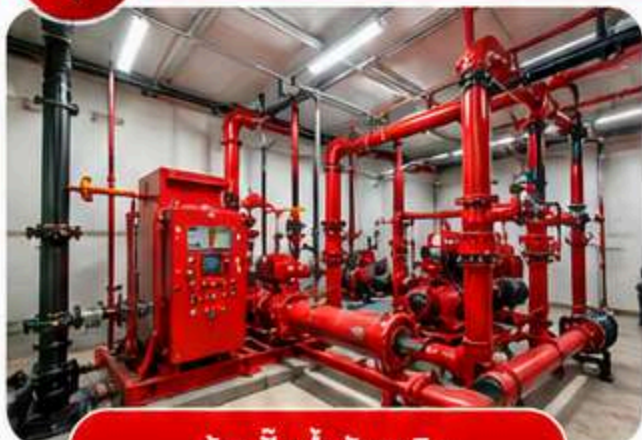
ห้องปั้มน้ำดับเพลิง
