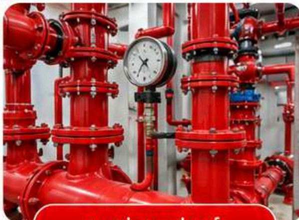
ระบบท่อและอุปกรณ์
