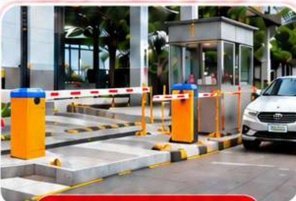
ระบบทางเข้า-ออกอัตโนมัติ
